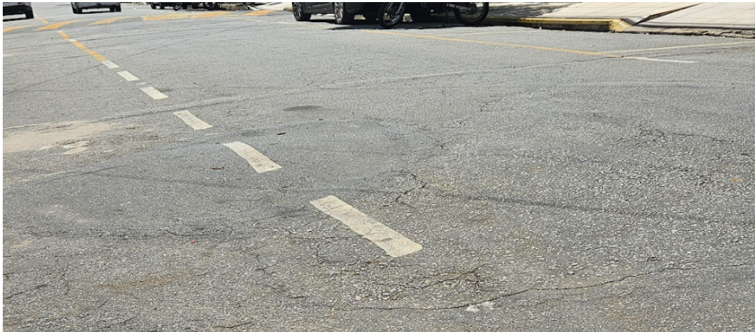
Figura 19 – Irregularidade Lombada Rua Serra do Mar
